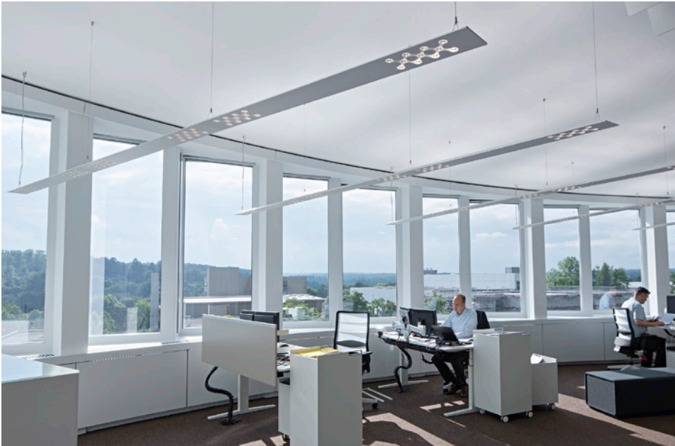
Die Beleuchtung der Büroräume erfolgt über radial angeordnete Leuchten – in diesem Falle die Neximo von TRILUX.
