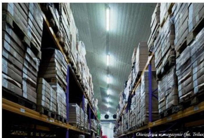
Oświetlenie w magazynie (fot. Trilux)
