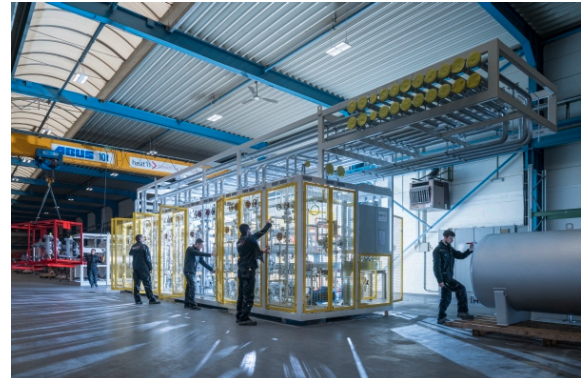
[Foto: Mirona_0_180313_067.jpg] Zu exzellenten Produktionsbedingungen gehört auch eine optimal konfigurierte Beleuchtungsanlage. Foto: TRILUX
