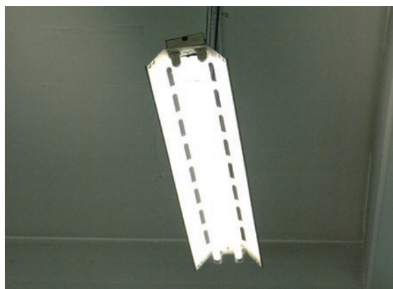
Voorziet men de montagebalk van een reflector? Dan wordt het licht richting werkplek gestuurd en kan men volstaan met de helft van het oorspronkelijk aantal tl-buizen.
