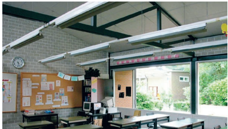
Voorzie men de montagebalk van een reflector? Dan wordt het licht richting werkplek gestuurd en kan men volstaan met de helft van het oorspronkelijk aantal tl-buizen.
